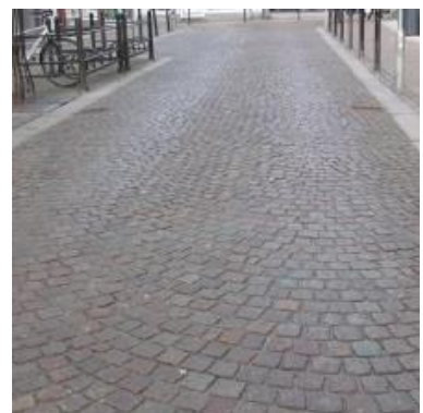
8900_37: Yderst jævn chaussébelægning.
