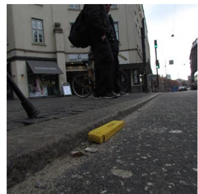
8000_14: Høj kant i forgængerovergange.
