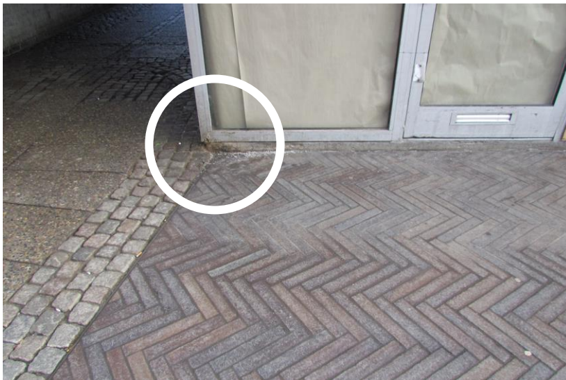
Billede: 8900_50: Fugtskade efter ny belægning er udført med bagfald.
