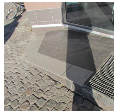
5100_004: Yderst dårlig rampe
