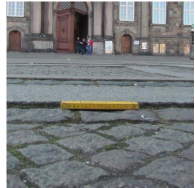
5100_11: Højdeforskel på 10 mm. ved alle belægningsskift.
